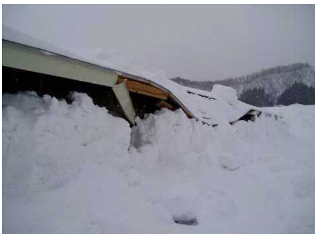
写真 37 畜舎軒先の損壊状況
