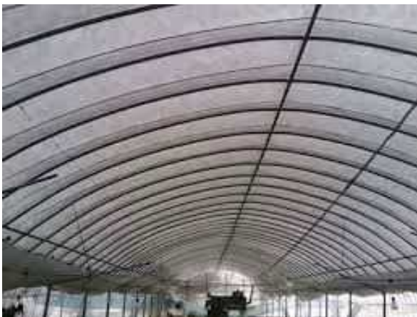
写真 32 屋根面に着雪し、融雪が必要となっているハウスの状況
