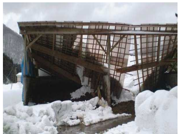
写真 38 堆肥舎屋根の損壊状況
