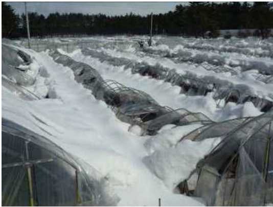
写真45 倒壊したハウスの状況 (外側)
