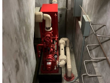
21 消火栓ポンプ室
