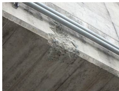
写真-2 頂版（剥離）
