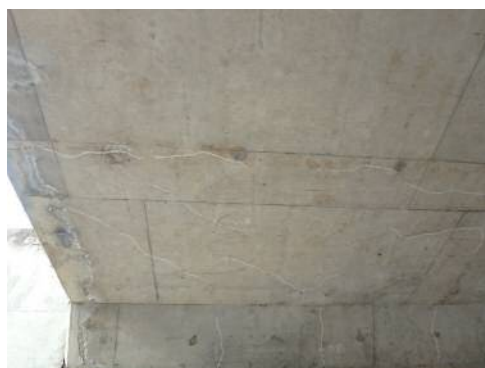
写真-1 頂版（ひびわれ）
